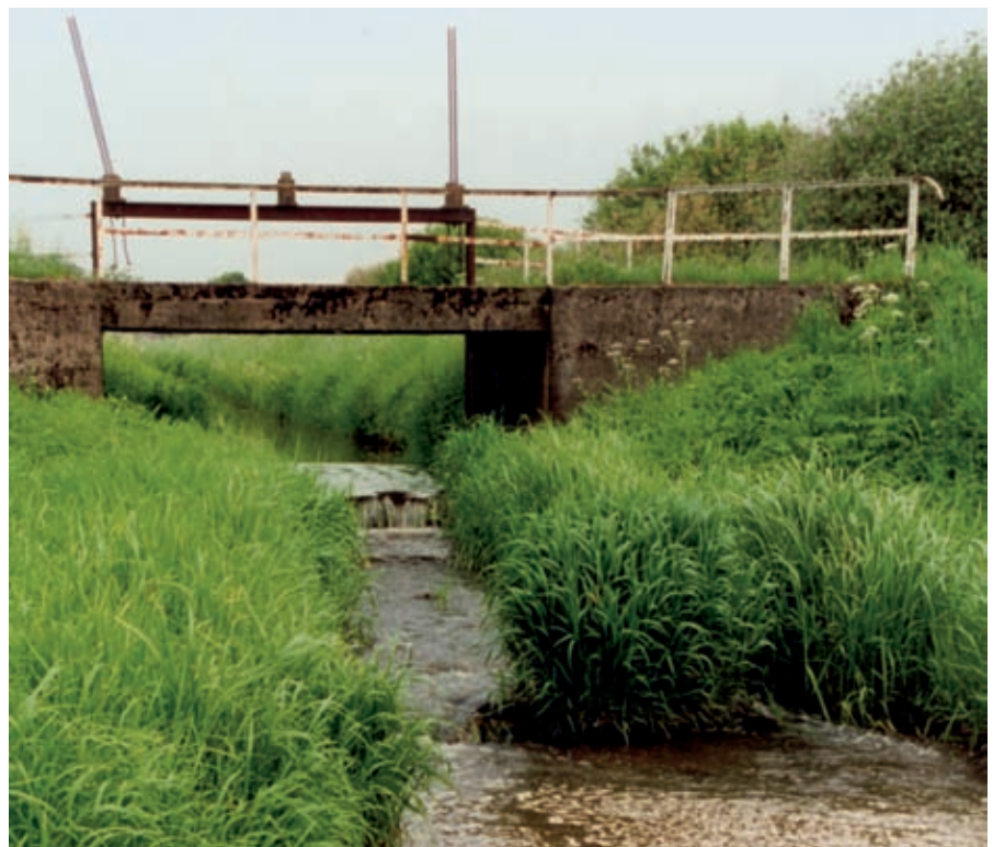
Kolk vor Unterquerung der Autobahn.
